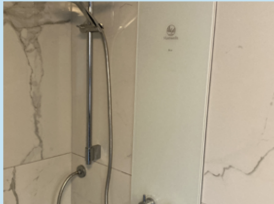
De warmtewisselaar bevindt zich achter het douchepaneel.
