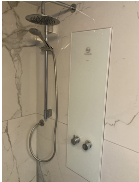
Deze speciale douchewarmtewisselaar kan binnen dezelfde bouwlaag geplaatst worden en is daarmee beter geschikt voor optoppingen dan standaard warmtewisselaars. Daarbij bevindt de warmtewisselaar zich meestal in de verdieping onder de badkamer.
