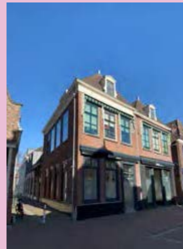
Voorzetglas aan de buitenzijde plaatsen is vanwege kleur, spiegeling en vervlakking van de gevel niet gewenst.
